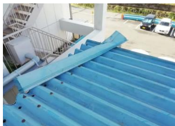
工場の屋根押えがめくれあがり大きく破損した
