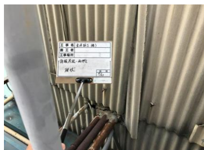
地震により、壁とパイプに大きな隙間が発生した
