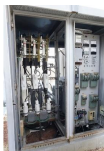
変電設備のトランスの傾きが生じた
